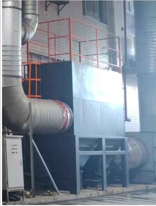
焊接烟尘袋式除尘器
